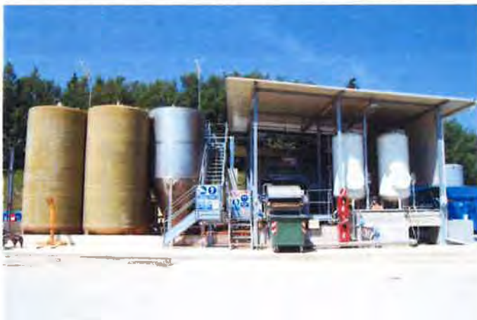
Figura 6: IMPIANTO DI TRATTAMENTO CHIMICO-FISICO (D9)
